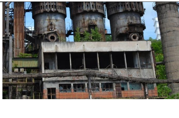
Figură 50 Degradări sau absență a tâmplăriilor. 228
