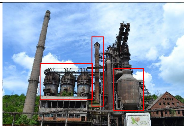
Figură 48 Se observă în general degradări datorate corodării metalului. 226
