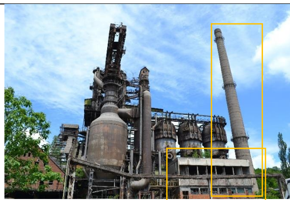
Figură 47 Se observă în general degradări ale betonului armat. 225
