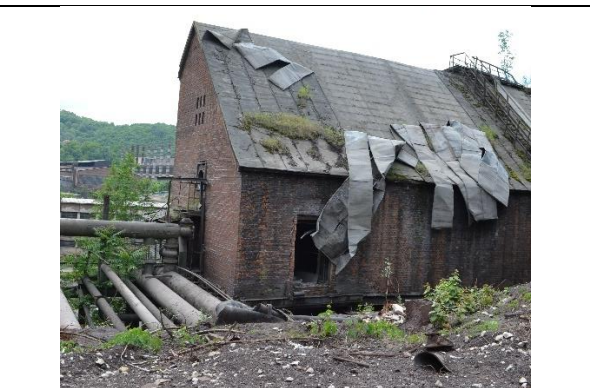
Figură 49 Degradări la nivelul învelitorii clădirilor. 227
